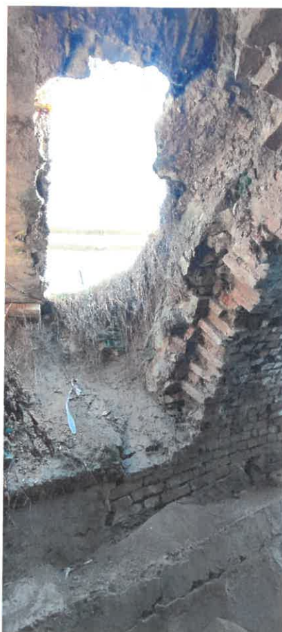
A gyalogjárda melletti beszakadt boltozat
