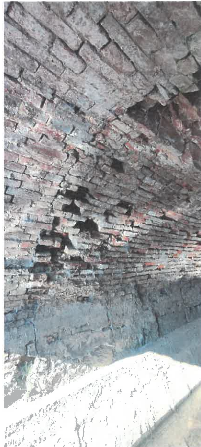
A boltozat állapota a bef. végtől ~1 m-re hiányzó téglák, kissé megrogyott boltozat
