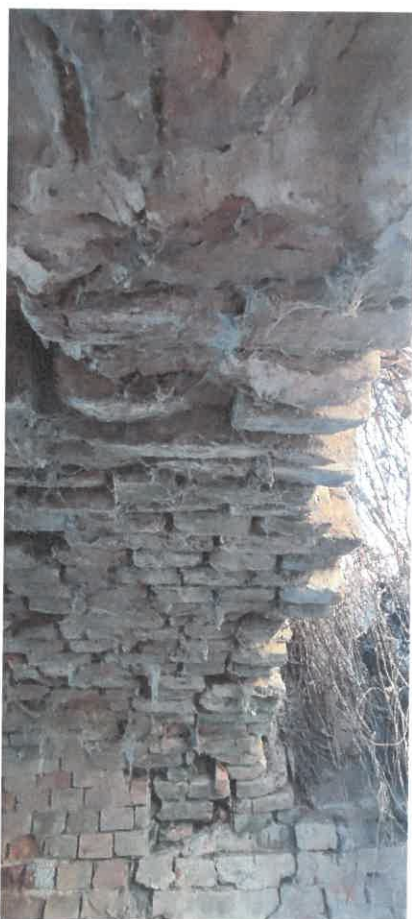
A beszakadás melletti boltozatrész hiányos hézagok, már kiesett téglák.
